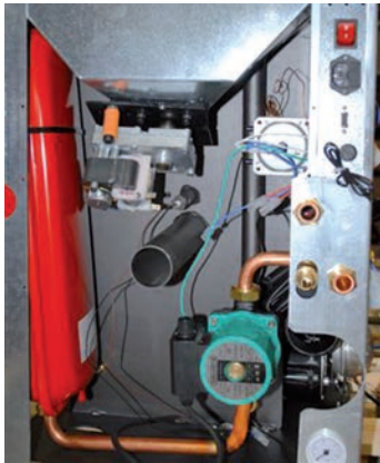
Interior caldera con sus componentes
